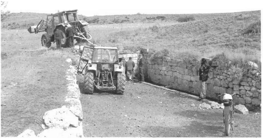
Fuente de Cutanda. Utilización de los tractores para el vaciado del arca de almacenamiento.
