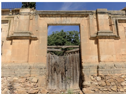
Palacio barroco inconcluso de Used. Puerta de acceso izquierda. Puede apreciarse perfectamente la súbita interrupción de las pilastras que enmarcan el vano por el abandono de la obra, así como el detalle de la moldura que enmarca los sucesivos vanos.
